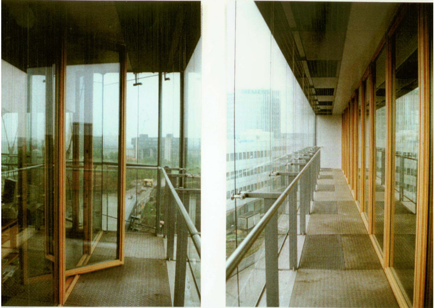
Das Düsseldorfer Stadttor Fensterlüftung über die doppelschalige Fassade
